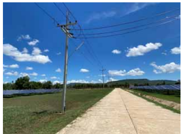
เสาไฟ 22 KV
