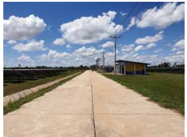
สภาพถนนทางเข้า-ออกในโครงการ
