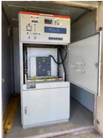
อุปกรณ์ตัดตอนไฟฟ้า 22KV
