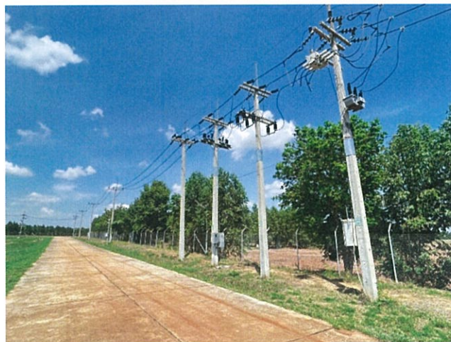
เสาไฟ 22 KV
