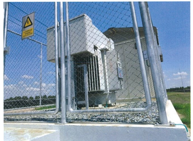
หม้อแปลงไฟฟ้า ยี่ห้อ QTC ขนาด 1250 Kva
