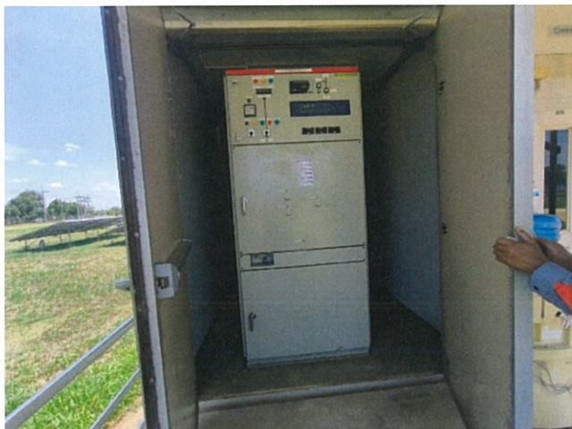
อุปกรณ์ตัดตอนไฟฟ้า 22KV
