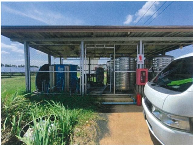
สภาพส่วนโค้งหลังคาคลุม (ปั้มน้ำสุขาภิบาล)
